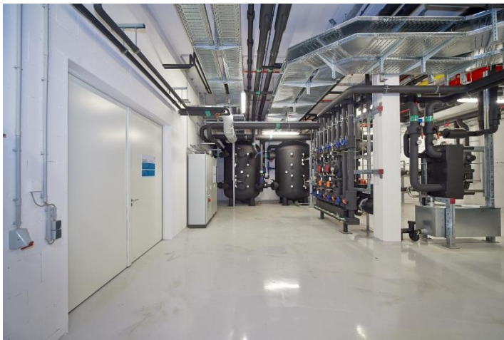
Bild 7: Weiß lackierte Stahl-Feuer- und Rauchschutztüren trennen die Haustechnikbereiche von der Flurzone und dienen dem baulichen Brandschutz.
